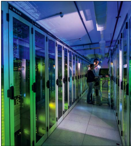
Hochsicherheitsbereich: Techniker kontrollieren Server im Karlsruher 1&1-Rechenzentrum.
