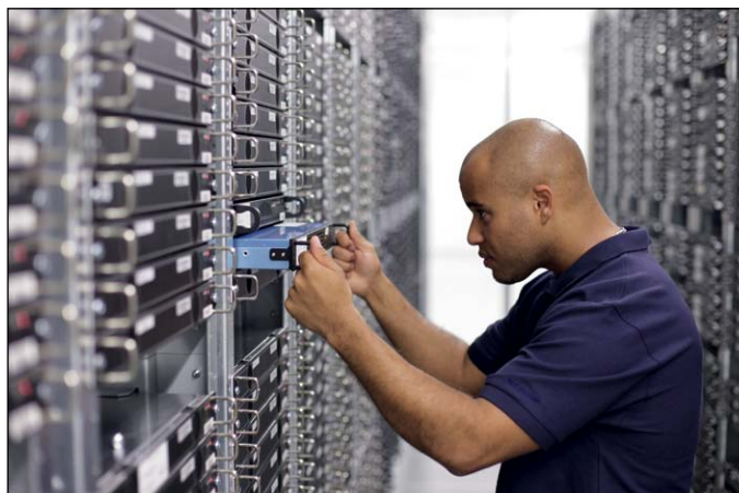
Ein Strato-Mitarbeiter wechselt einen der vielen dedizierten Server im Rechenzentrum aus.
