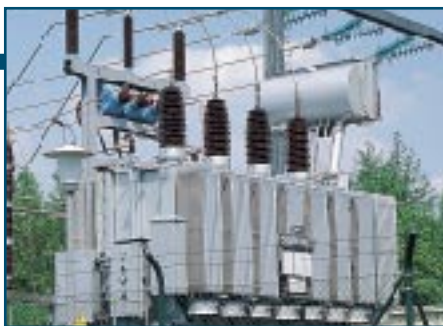
Bild 1: Großtransformatoren in Umspannwerken sind eine leistungsfähige Quelle vor allem magnetischer Felder.
