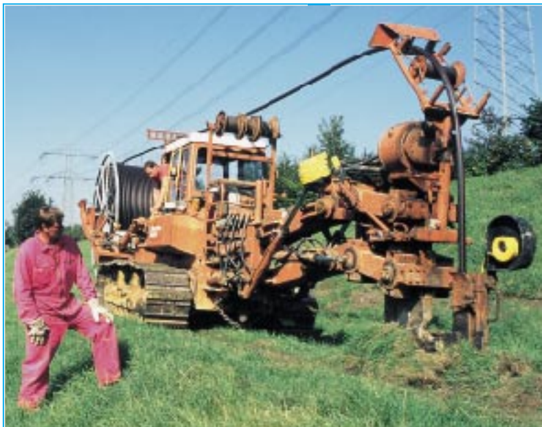
Bild 4: Damit können die Stromkonzerne wuchern: sie verfügen über leistungsfähige Kabelnetze entlang der Energietrassen. Foto: O.tel.o
