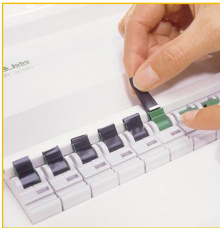
Bild 5: Befestigung der Magnete mit Hilfe von Klebeband
