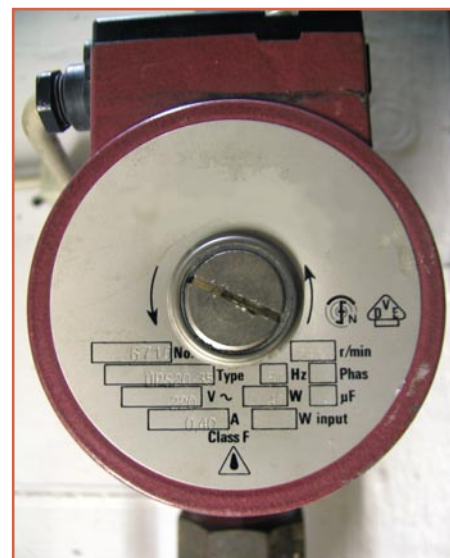
Bild 4: Dank robuster Technik sind noch in vielen Heizungskellern längst veraltete Umwälzpumpen am Werk.
