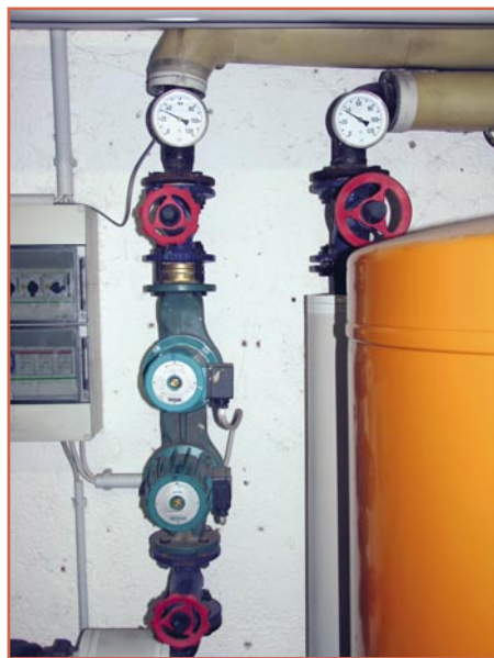
Bild 1: Umwälzpumpen im Heizungskeller – hier wird oft unnötig viel Strom verbraucht.
