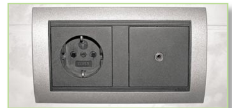
Bild 16: Mittels Blindplatte und Klinkebuchse selbstgebaute Multimedia-Dose für Ein- und Ausgabe
