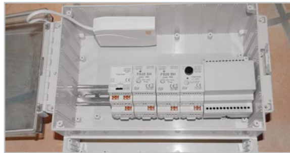
Bild 3: Die FS20-Komponenten finden in einem Verteilergehäuse mit HutschieneMontage ihren Platz.
