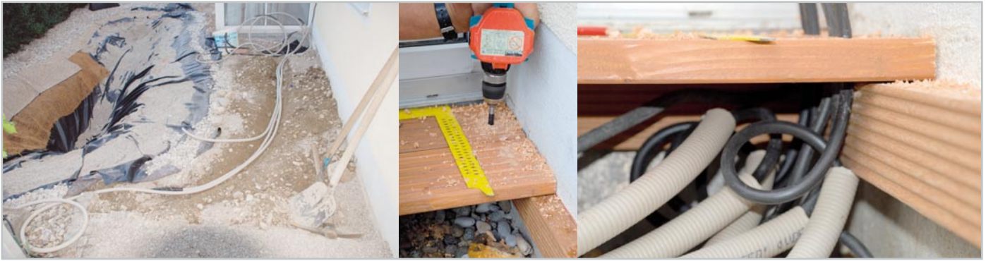
Bild 1: Der Gartenteich im Bauzustand sowie die Verlegung der Kabel durch die Terrasse
