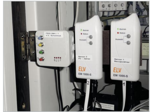
Bild 4: Über das Schaltmodul FS20 SM4 sind Funk-Taster, Bewegungsmelder und Thermostat angekoppelt. Daneben noch die Sendeeinheiten für das Energieerfassungssystem EM 1000.
