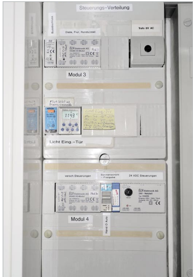
Bild 2: Die Module 3 und 4 sowie Uhr 3 für die Lichtsteuerung
