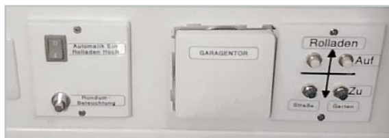
Bild 7: Die zentralen Bedienungselemente für Licht- und Rolladensteuerung
