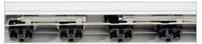
Bild 7: Hier ist die exakte Lage aller Stromschienen zu sehen.
