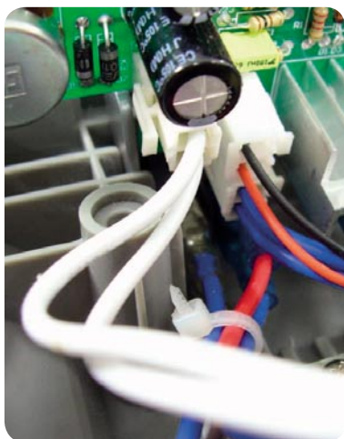
Ausgangszustand: keine Isolierung zwischen 230-V-Seite und Sekundärseite (Steuerelektronik)
