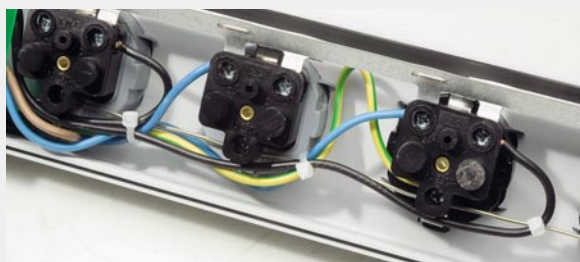
Bild 4: So fixiert hat ein Leistungsende auch beim Lösen aus der Verschraubung keinen großen Aktionsradius und löst allenfalls FI- oder LS-Schalter aus.
