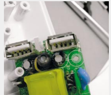
Bild 10: Die USB-Buchsen-Gehäuse sind von außen berührbar – sie gehören an den Schutzleiter angeschlossen oder müssen durch eine entsprechende zugelassene Isolierung von der Netzseite getrennt sein.
